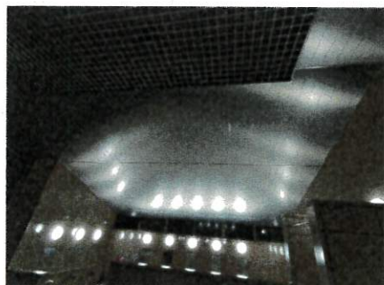
男子浴室天板修繕
